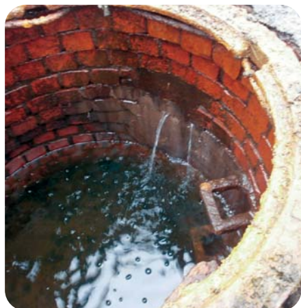
Defekter Schacht einer Abscheideranlage
